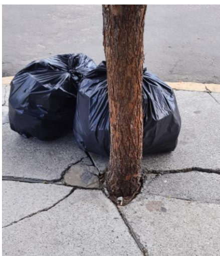
Figura 10: Conflitos de raízes com pavimentação/canteiros
