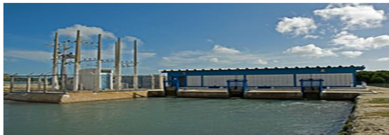
Figura 15 Estação de bombeamento (foto representativa)
