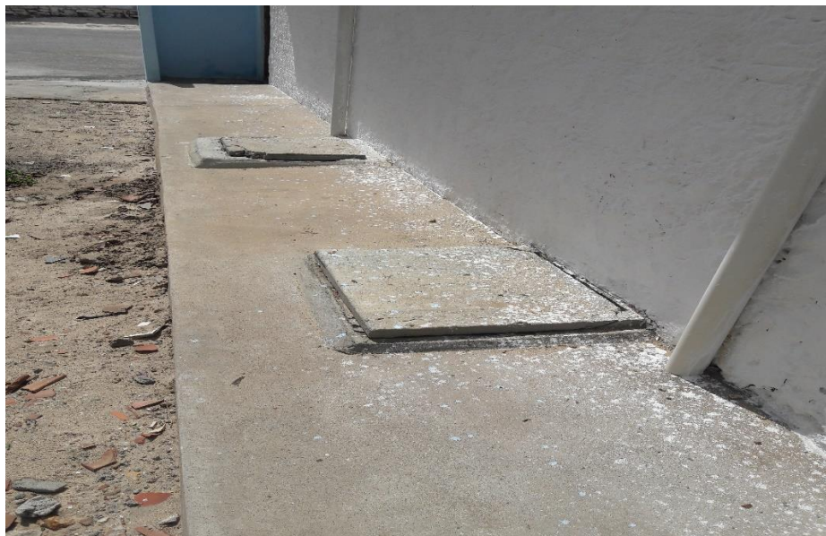
Figura 08 – Caixas coletoras de gorduras – Barraca da Praia de Upanema Foto: Erika Souza (2018)
