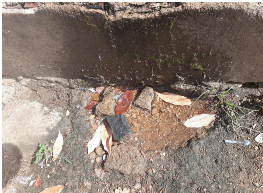
Poça de água do ar condicionado
