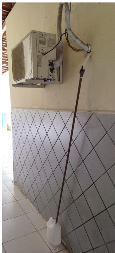
Figura 1: Sistema de captação provisório
